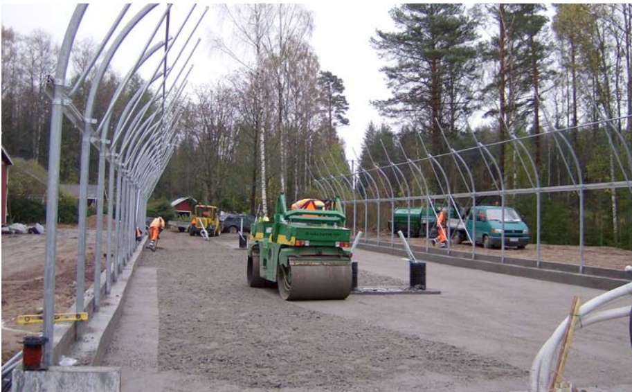
Kuva 9. Asvaltointityö on alkanut. Meneillään on alusrakennemurskeen tasoitus ja jyräys. Rungon peruspilarit ja kaarien lähdöt ovat jo asennettuina. (Kuva: Samuli Näri)
