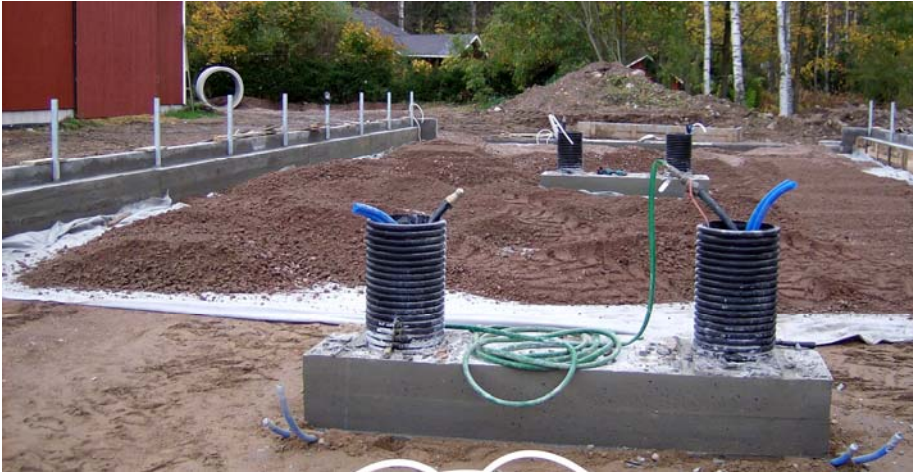
Kuva 8. Tiivistetyn perusmaan päälle asennettiin suodatinkangas, jonka päälle tuli mursketta asvaltin alusrakenteeksi. Etualalla vesijohtojen nousut ja vesikoppien asennusholkit. (Kuva: Samuli Näri)
