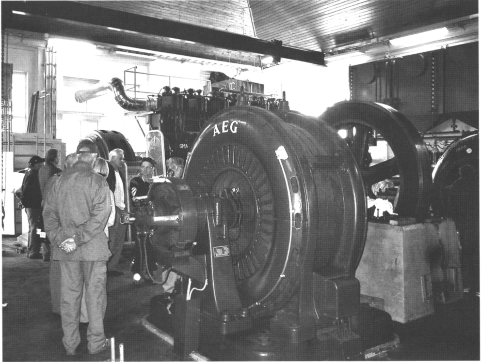
Lestijokiretkeläisiä Korpelan vesivoimalaitoksessa (kuva: Esa Heino/Metla).
