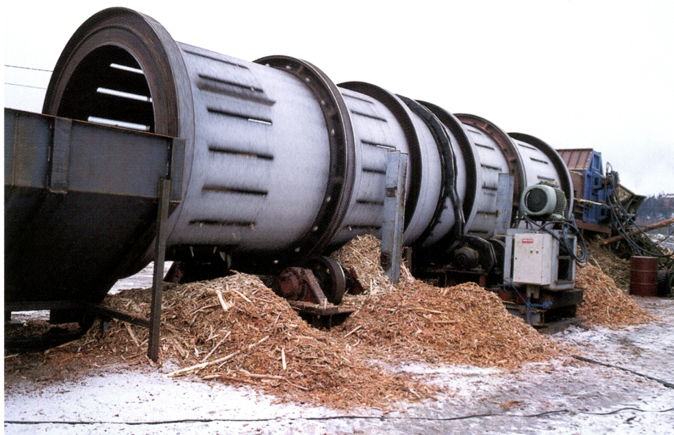
Kuva 20. Yhdistelmäkuorimon kuivarumpu lähikuvassa. Etualalla kuoriaukkojen läpi pudonnutta prosessitähdettä.
