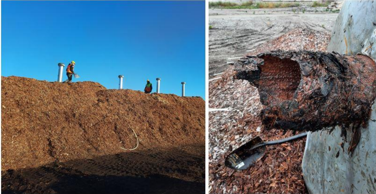
Kuva 10. Uimaharjun varastointikokeessa toiseen männynkuoriaumaan asennettiin neljä tuuletinta, joita käytettiin aikaisemmin Kuopion varastointikokeessa. Galvanoidusta 1 mm:n teräksestä valmistetut tuuletusputket syöpyivät kuoriaumoissa voimakkaasti.
