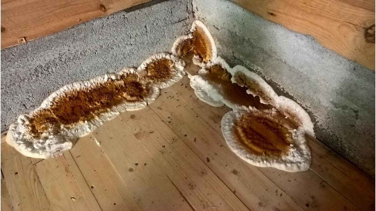
Kuva 17. Aggressiivisesti leviävä lattiasieni hyökkäsi nopeasti varastorakennuksen virheellisesti rakennetun puulattian kimppuun (lattian alapuoli imi kosteutta, mutta ei tuulettunut).
