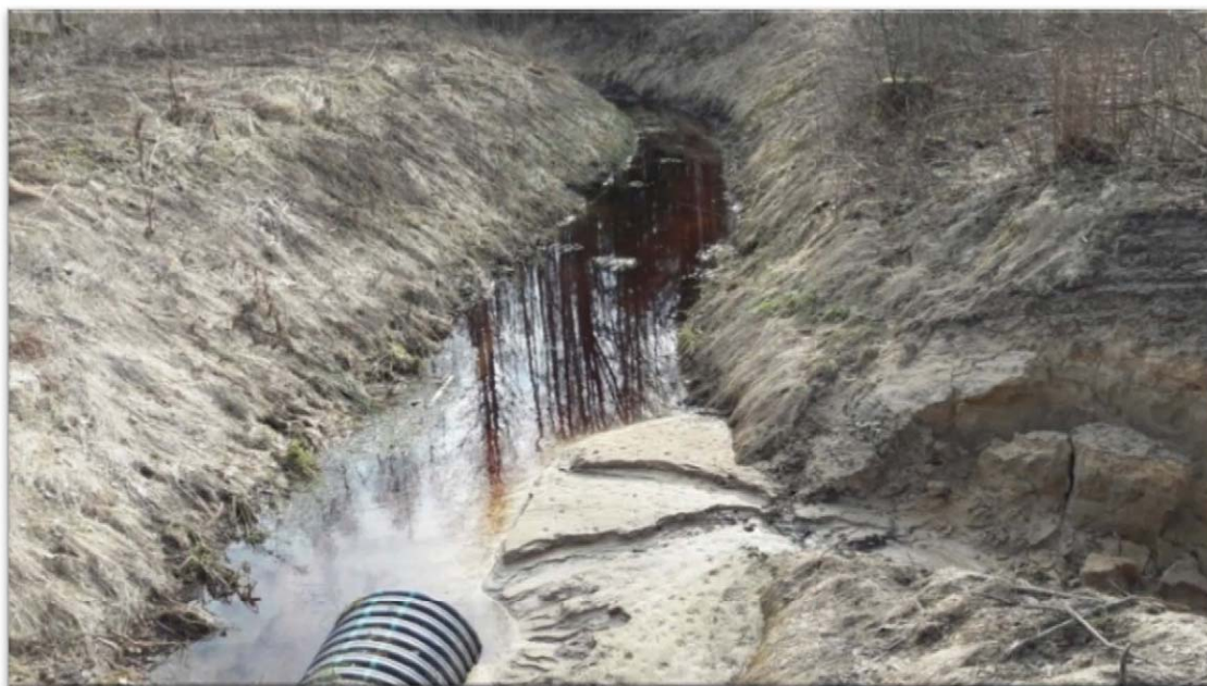
Kuva 5. Kuva ojasta, jota ei olisi pitänyt kunnostaa, koska eroosioherkkä maa aiheuttaa suurta kiintoainekuormitusta alapuoliseen vesistöön. Kuva Zane Libiete.
