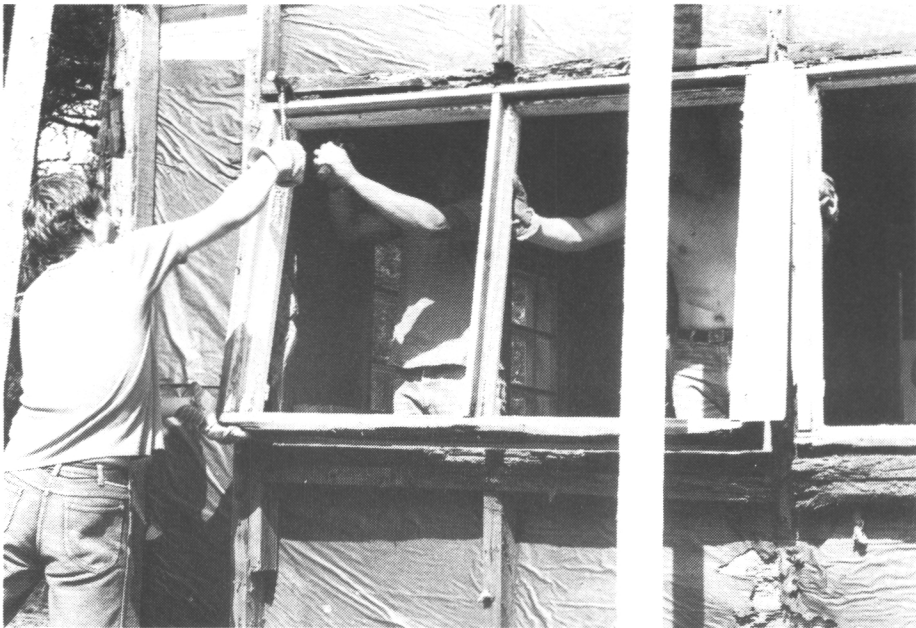
Mökin peruskorjaus tehtiin syksyllä 1985 ja keväällä 1986. Kerholaiset osallistuivat innokkaasti talkoisiin. Materiaalin kuljetuksessa oli mukana 40 henkeä ja talkoopäiviä kertyi viikonloppuisin runsaasti.
