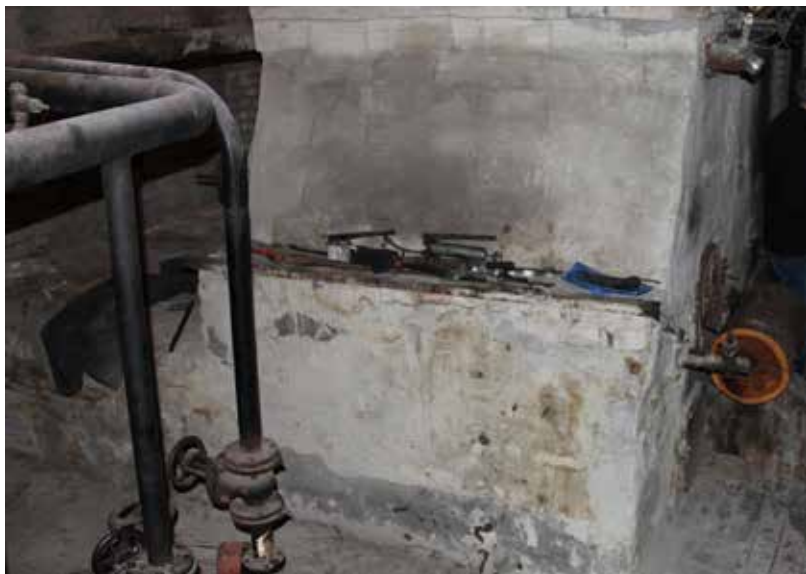
Рис. 5. В котельной при лесотехнической школе в п. Чална два котла на дровах марки Универсал-6. (Фото: Esa Etelätalo)
