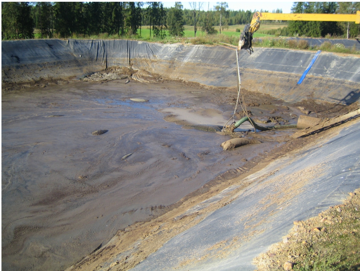
Kuva 3. Maanvaraisen lietteen varastoaltaan pohja nousee kuprulle ilmeisesti pohjavedenpaineen johdosta. Kuva Heikki Uotila.
