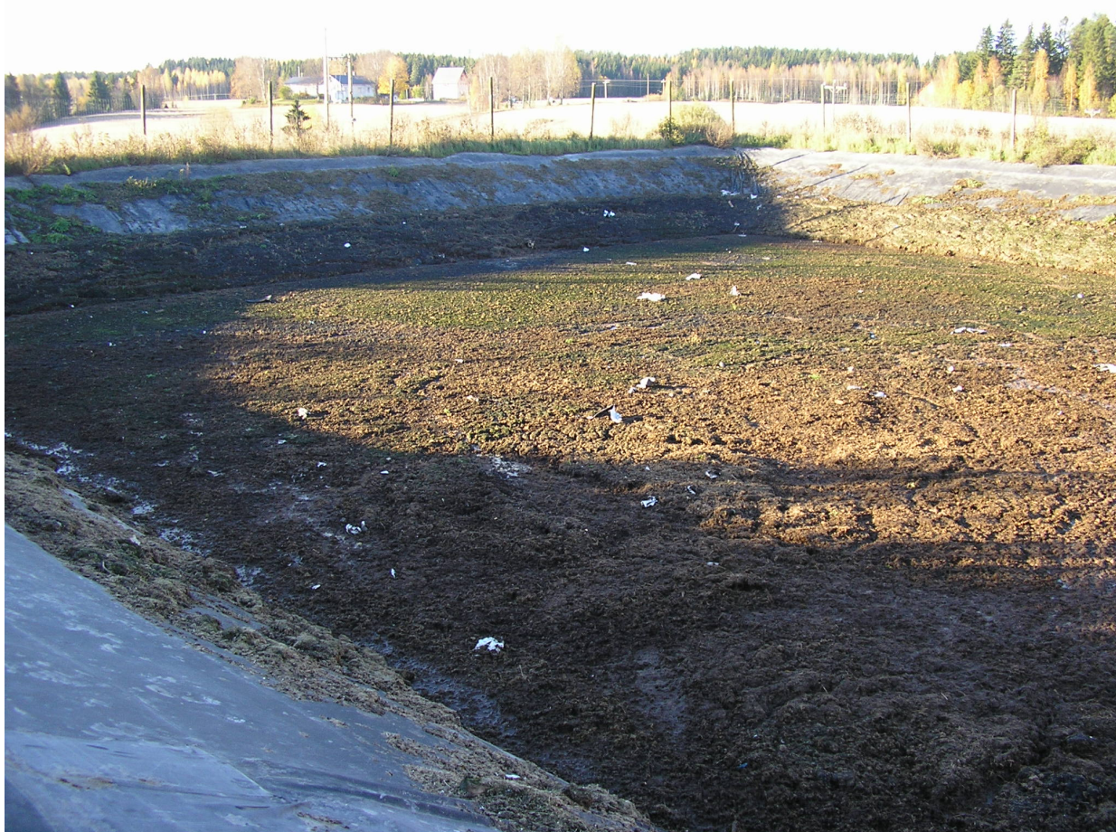
Kuva 4. Liettealtaan pintaan on kertynyt kuivaa kuorettumaa riittämättömän sekoituksen takia. Mikäli sekoitusta ei pystytä tehostamaan, joudutaan kuorettuma poistamaan esim. kaivinkoneella, mistä aiheutuu huomattava tiivistekalvon rikkoutumisriski. Kuva Teemu Ala-Kleme
