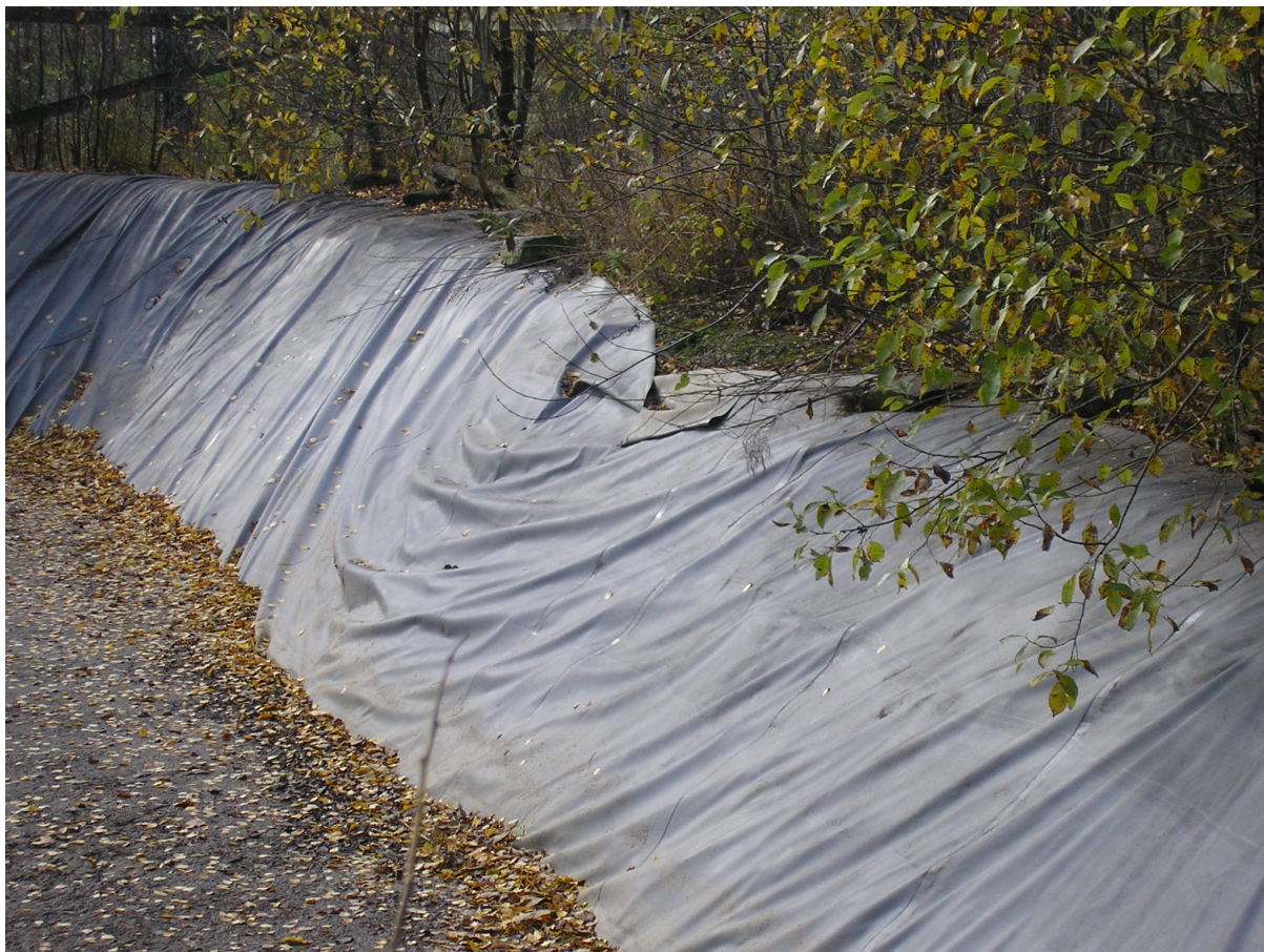
Kuva 7. Maanvaraisen lietealtaan tiivistekalvo on irronnut maavallikiinnityksestä liian pienen ylityksen takia. Kuva Teemu Ala-Kleme.
