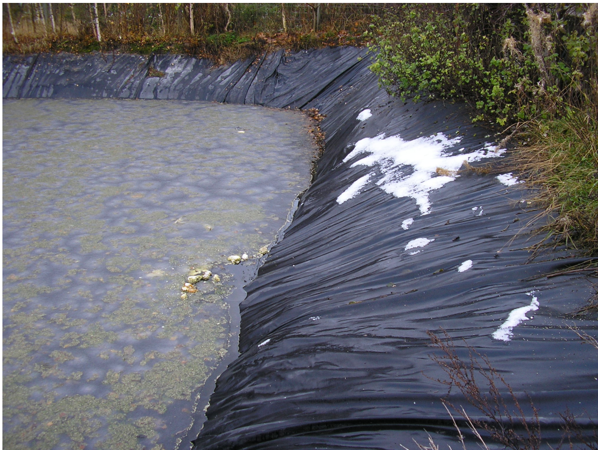
Kuva 6. Maavalli on pettänyt ja vajonnut osin altaaseen. Onneksi tiivistyskalvo ei ole rikkoontunut, altaan tilavuus on pienentynyt. Kuva Teemu Ala-Kleme.
