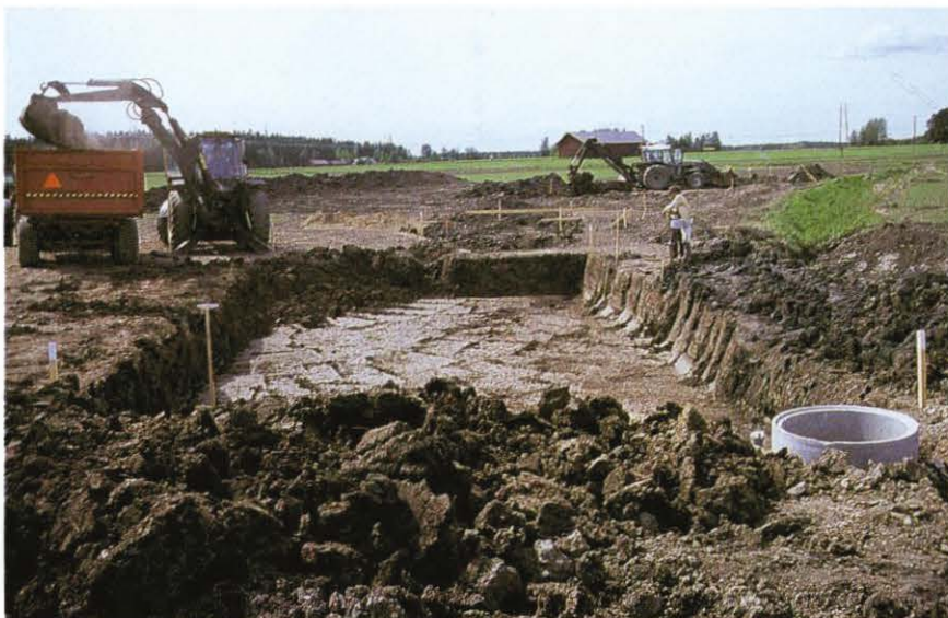
Kuva 8. Kosteikkokasviallas, etureunassa säätökaivo.
