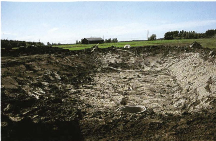
Kuva 7. Laskeutusallas; takareunassa vedenjakoputki, etureunassa keräilykaivo, josta vesi johdetaan kosteikkokasvialtaaseen.
