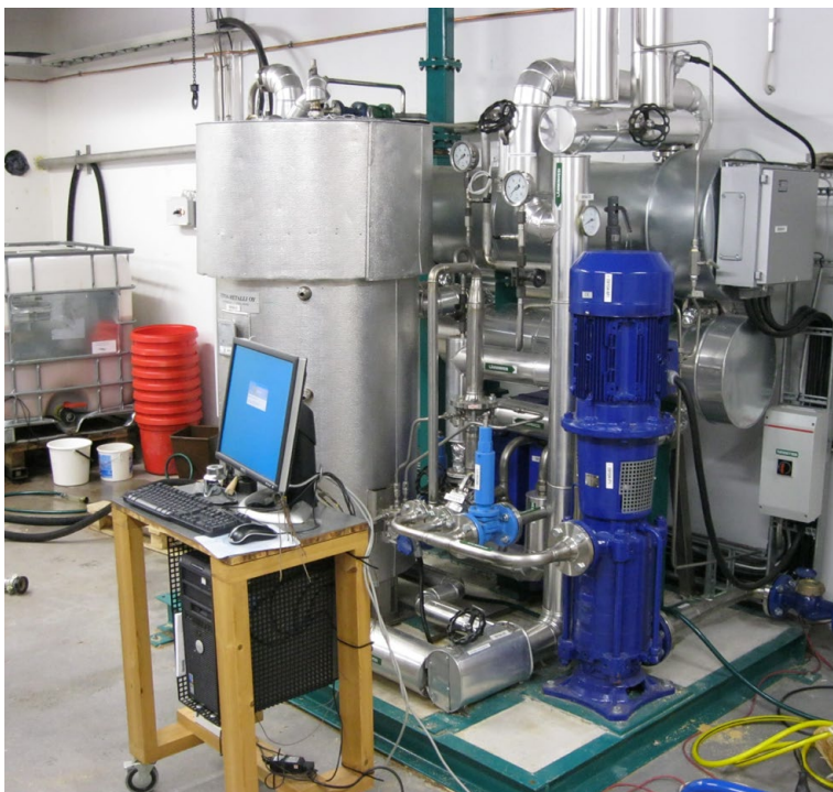
Kuva 23.3c. 300 litran uuttolaitteisto, jonka veden pumppamiseen käytettävä sininen suurtehopumppu (max. 100 l/min) näkyy kuvassa oikealla. 300 litran uuttokammio on kuvan keskellä oleva pystyasennossa oleva lieriö. Kaksi kuvassa vaakatasossa olevaa metallilieriötä ovat lämmönvaihtimia, joiden avulla uuttoliuoksen sisältämä lämpöenergia otetaan talteen samalla kun uute jäähdytetään huoneenlämpöiseksi. Uutteet kerättiin taustalla näkyviin kontteihin. Kuva Metla/Petri Kilpeläinen.
