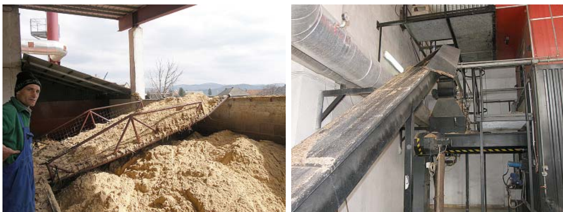
Рис. 78. Отопительная котельная, работающая на биомассе, в Инторсура-Бузаулуй (ISPE)
