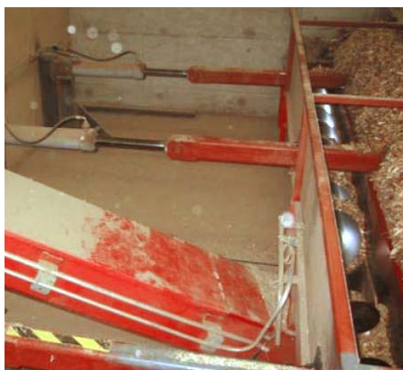
Рис. 37. Цепной разгрузчик (EUBIONET2) со шнековым транспортером. Топливо выталкивается из хранилища с правой стороны шнека (EUBIONET2)
