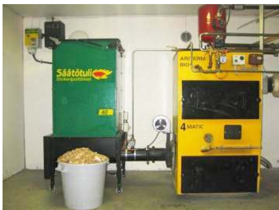
Рис. 40. Топка с механической решеткой (40кВт) и котел (30 кВт), обычная система для индивидуальной частной застройки (контейнер на 0.5 м³)
