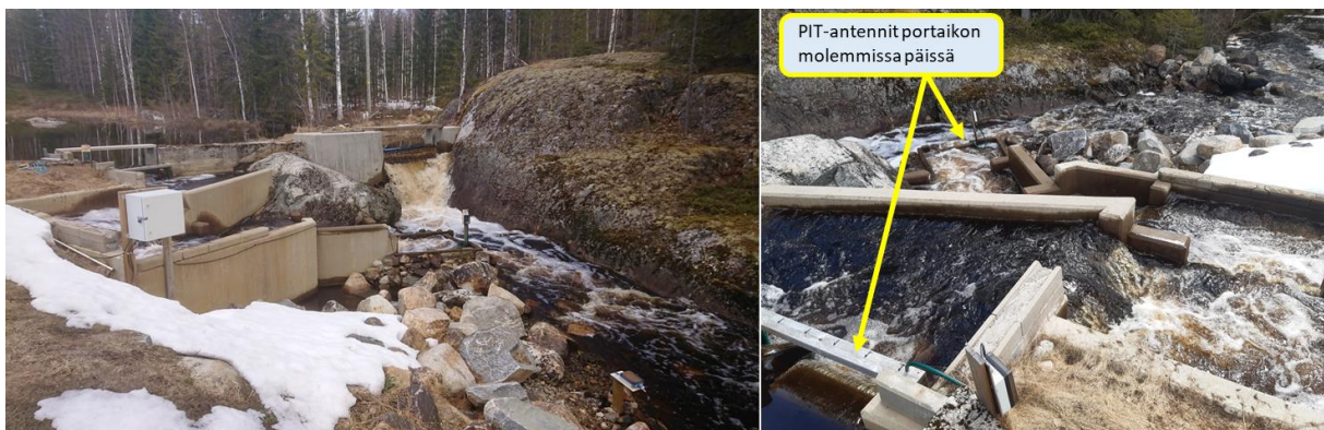
Kuva 43. Saarijoen pato ja kalatie kevättulvan aikaan, jolloin suurin osa joen virtaamasta juoksetettiin padon yli tulva-aukon kautta.
