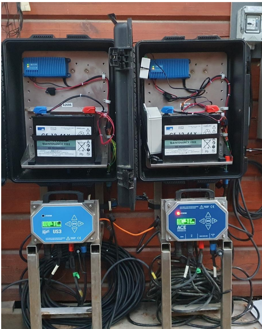
Kuva 17. Kahden Ace Aquatec US3 -hyljekarkottimen säätöyksiköt kotelon etukansi poistettuna. Jokaisella karkottimella on oma säätöyksikkö. Kuva: Esa Lehtonen (Luke)
