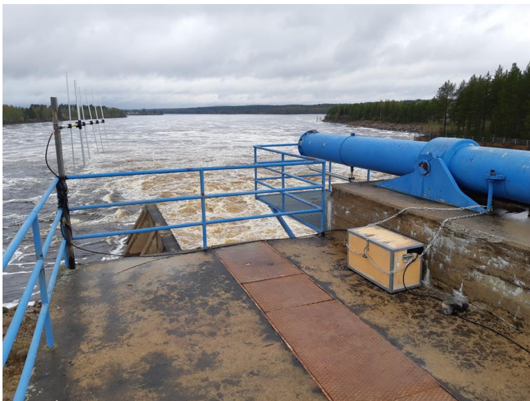
Kuva 3. Radiovastaanotin (laatikossa) ja kuusielementtinen Yagi-antenni asennettuna Valajaskosken ohjuusutuspadolle. Kuva: Panu Orell.
