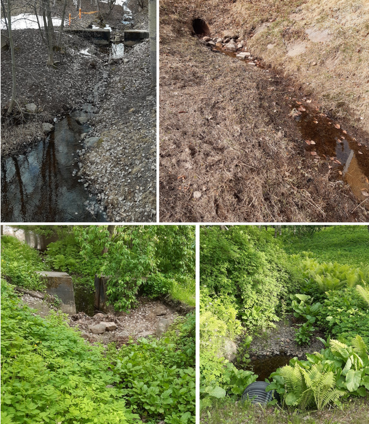
Kuva 22. Platan- ja Pakolansaarten välisen purouoman ala- ja yläosa ovat umpeenkasvanutta ja pääosin kuivaa uomaa. Kevyen liikenteen alittavat tierummut poistamalla, kynnyksen poistamisella, vesitystä lisäämällä ja uomaa raivaamalla sekä kunnostamalla kalojen liikkuminen voisi olla mahdollista. Ylemmät kuvat on otettu 26.4.2022, alemmat 15.6.2022. Kuvat: Riku Rinnevalli, Luke.
