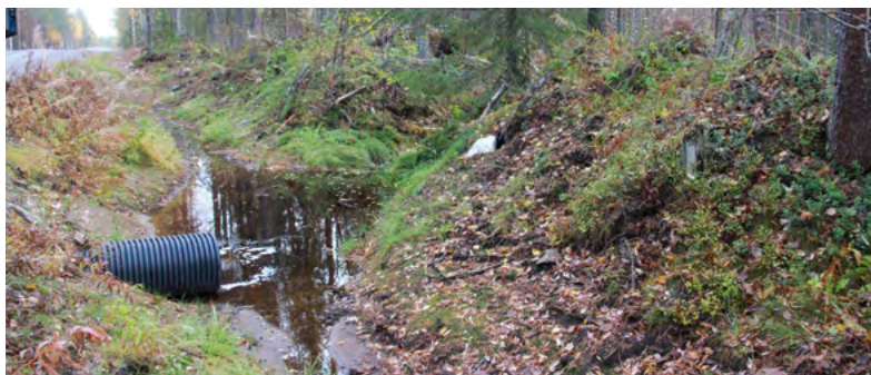
Рисунок 53. Правильно спроектированное и смонтированное водопрпускное сооружение может служить без ремонта в течение многих десятков лет.
