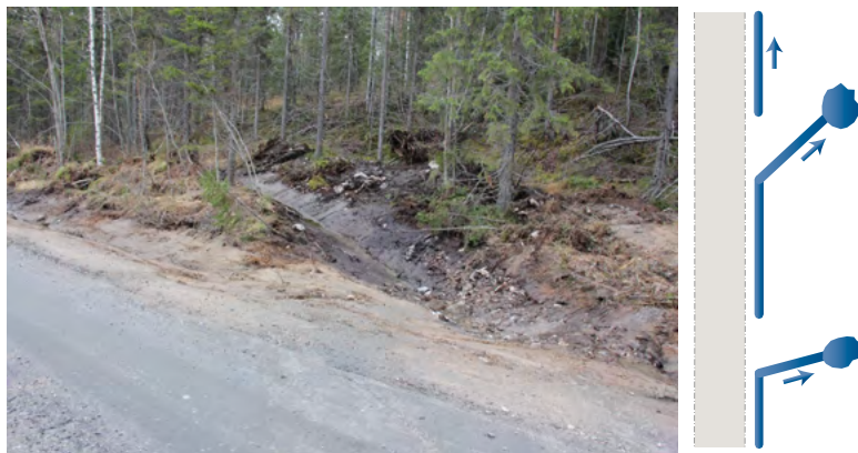
Рисунок 59. Через определенные отрезки линия канавы отводят в сторону перпендикулярно дороге. Расстояние между водоотводными канавами составляет несколько десятков метров. Водоотводная канава заканчивается дренажной ямой.
