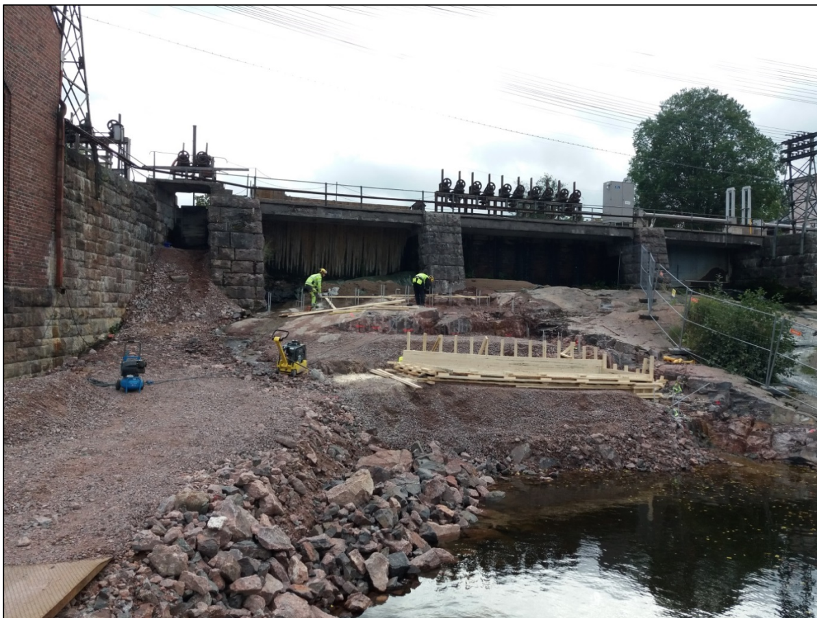
Kuva 3. Tästä kalatien rakentaminen alkaa. Billnäsin kalatie rakennettiin tukevalle kal-liopohjalle. Kuva: Viliina Evokari.
