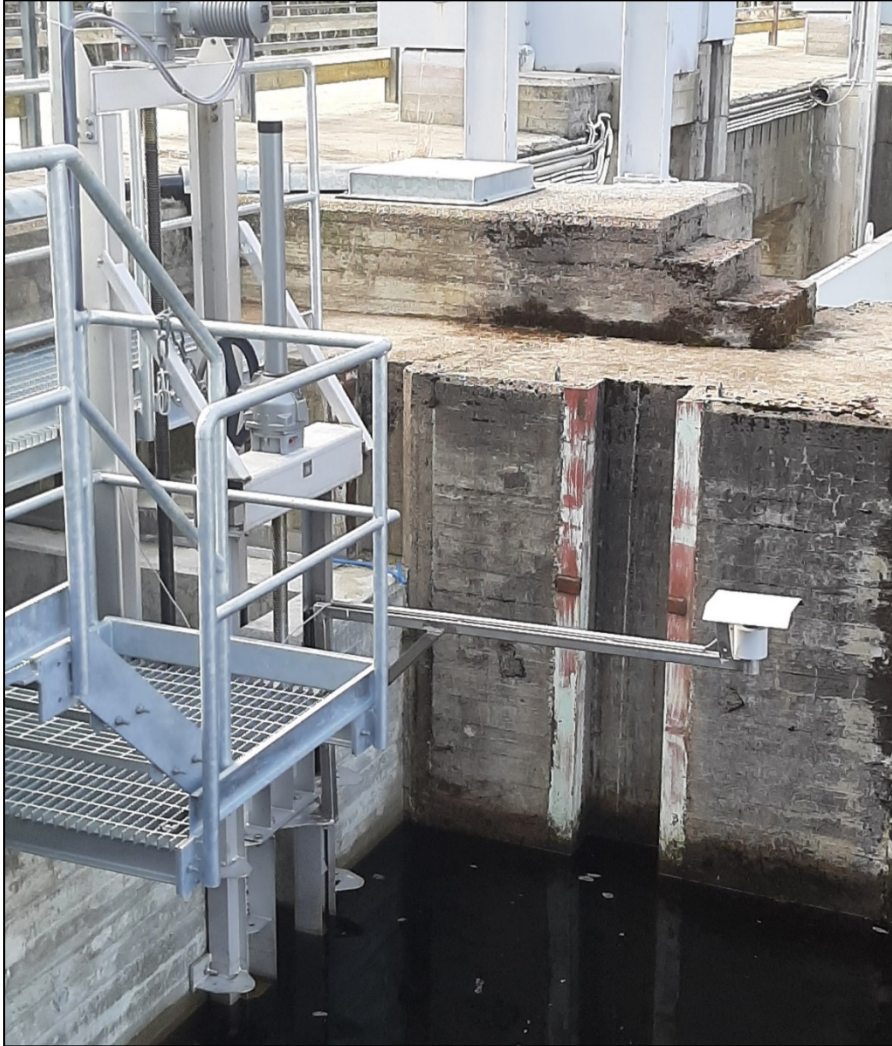
Kuva 5. Vedenpinnan vaihtelun vuoksi kalatiehen menevää virtaamaa voidaan joutua säätämään joko manuaalisesti tai automaattisesti. Saarijärven reitillä Hietaman kalatiessä ultraääni-anturi mittaa vedenpinnan korkeutta jonka mukaan kalatiehen menevän veden määrää voidaan säätää. Kuva: Teppo Vehanen.
