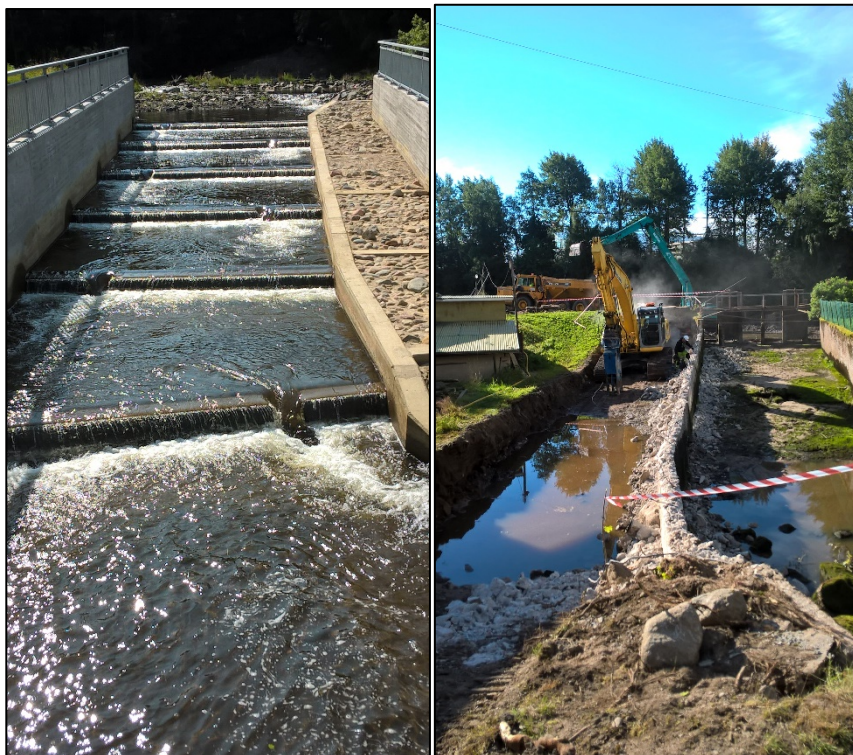
Kuva 4. Isojoen meritaimen pääsee jälleen nousemaan kalatietä pitkin Villamon entisen padon yläpuolisille alueille. Kalaseurantojen tulokset ovat lupaavia jo ensimmäisen toteutusvuoden jälkeen padon poistamisesta (Luke.fi-uutinen 8.11.2019). Kuvat: Etelä-Pohjanmaan ELY-keskus.
