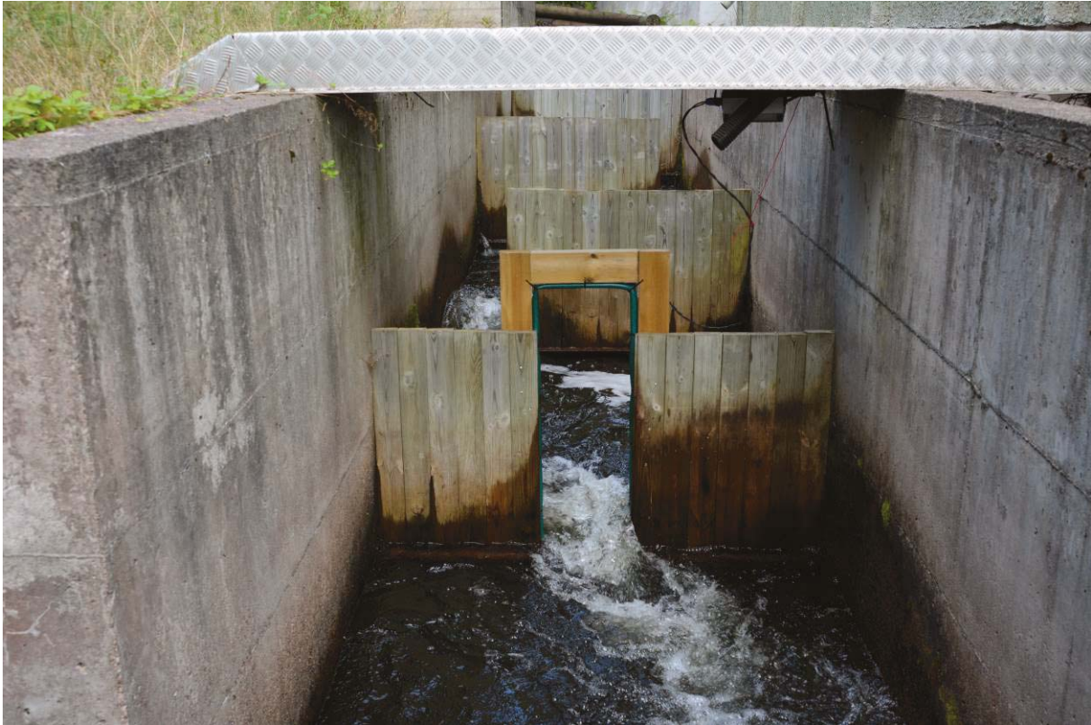
Kuva 8. Kymijoen Koivu- ja Korkeakosken kalateihin on asennettu PIT-mikrosirujen lukuasemat, joiden avulla voidaan seurata vaelluskalojen hakeutumista kalatiehen ja samalla arvioida kalateiden toimivuutta. Kuvassa Koivukosken säännöstelypadon kalatie. Kuva: Panu Orell
