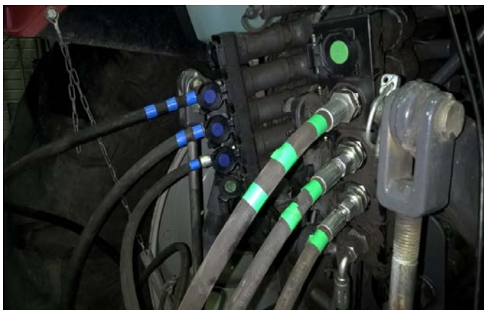
Kuva 33. Esimerkki hydrauliikkaletkujen tarkoituksenmukaisesta merkinnästä (Kuva: Matts Nysand).
