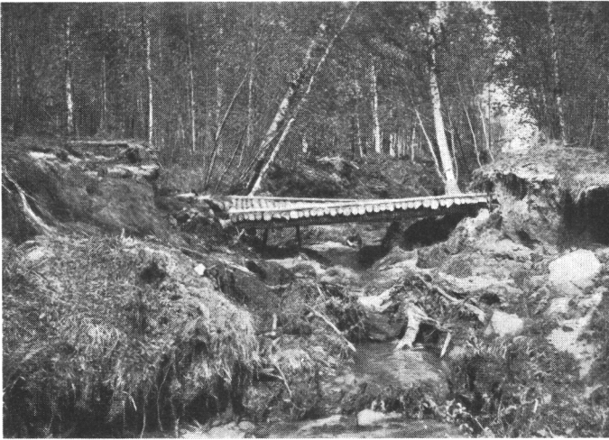
Kuva 7. Laskuojan syöpyessä sortunut ajosilta. Raivolan kokeilu- alue, Metsolan tila.
