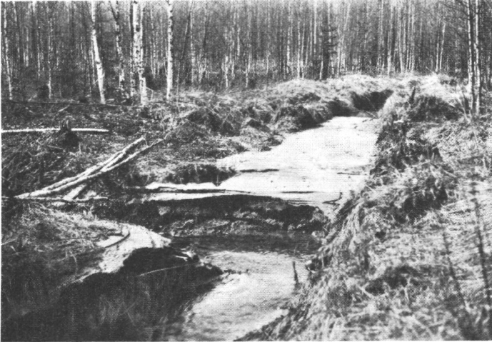
Kuva 3. Syöpyneestä ojasta kulkeutuneen hiekan tukkima heikkolaskuinen oja. Tuusula, Ruotsinkylä.
