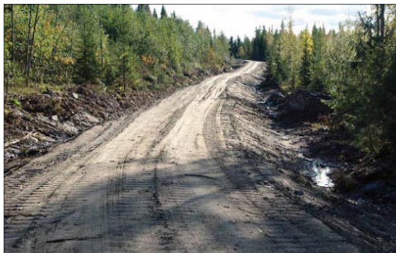
Рис. 15. Прежде чем начнется строительство покрытия и непосредственно эксплуатация, основанию строящегося уха дадут в течение зимы уплотниться
