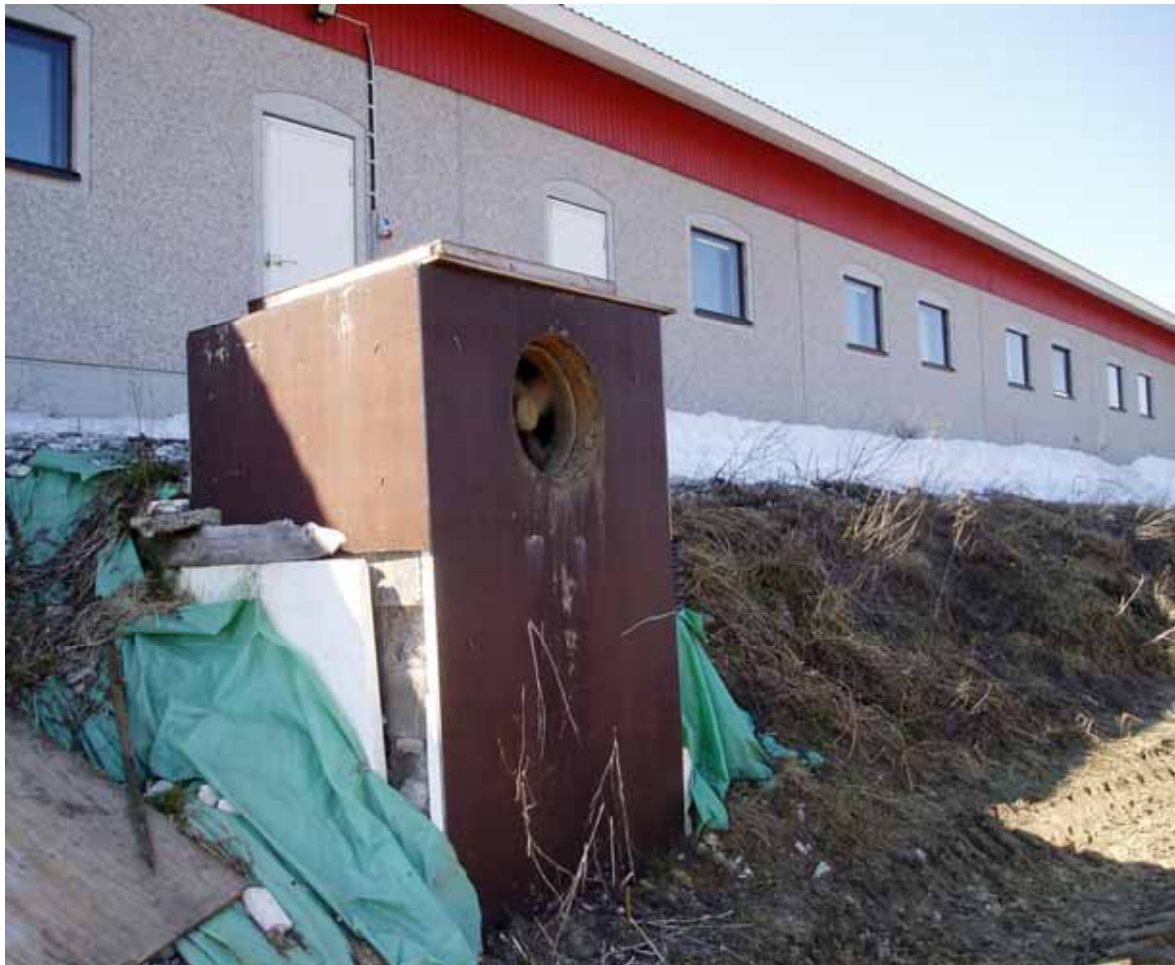
Ilmanvaihdon alaimu pihatossa. Puhaltimen pysähtyminen voi olla kohtalokasta, sillä haitallisten kaasujen pitoisuudet voivat kohota vaarallisiksi. Kuva: Pekka Jauhiainen.
