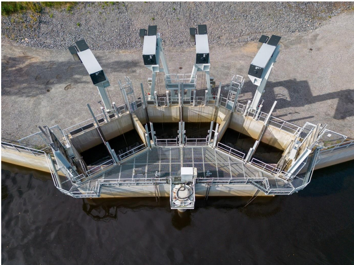
Kuva 3. Montan voimalaitoksen alakanavan pohjoisrannalla sijaitseva kalojen kiinniottolaite. Kuva: Jari Lindeman, Luke
