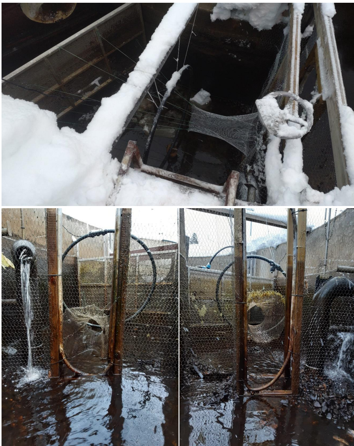
Kuva 6. Yllä nielurakenne kynnyksellä ylhäältäpäin kuvattuna. Alla nielurakenne kynnyksettömänä ja kiristettynä, 13 cm (vasen) ja kynnyksen kanssa avoimena 25 cm (oikea). Taustalla näkyy rysän sisälle asennettu PIT- antenni.
