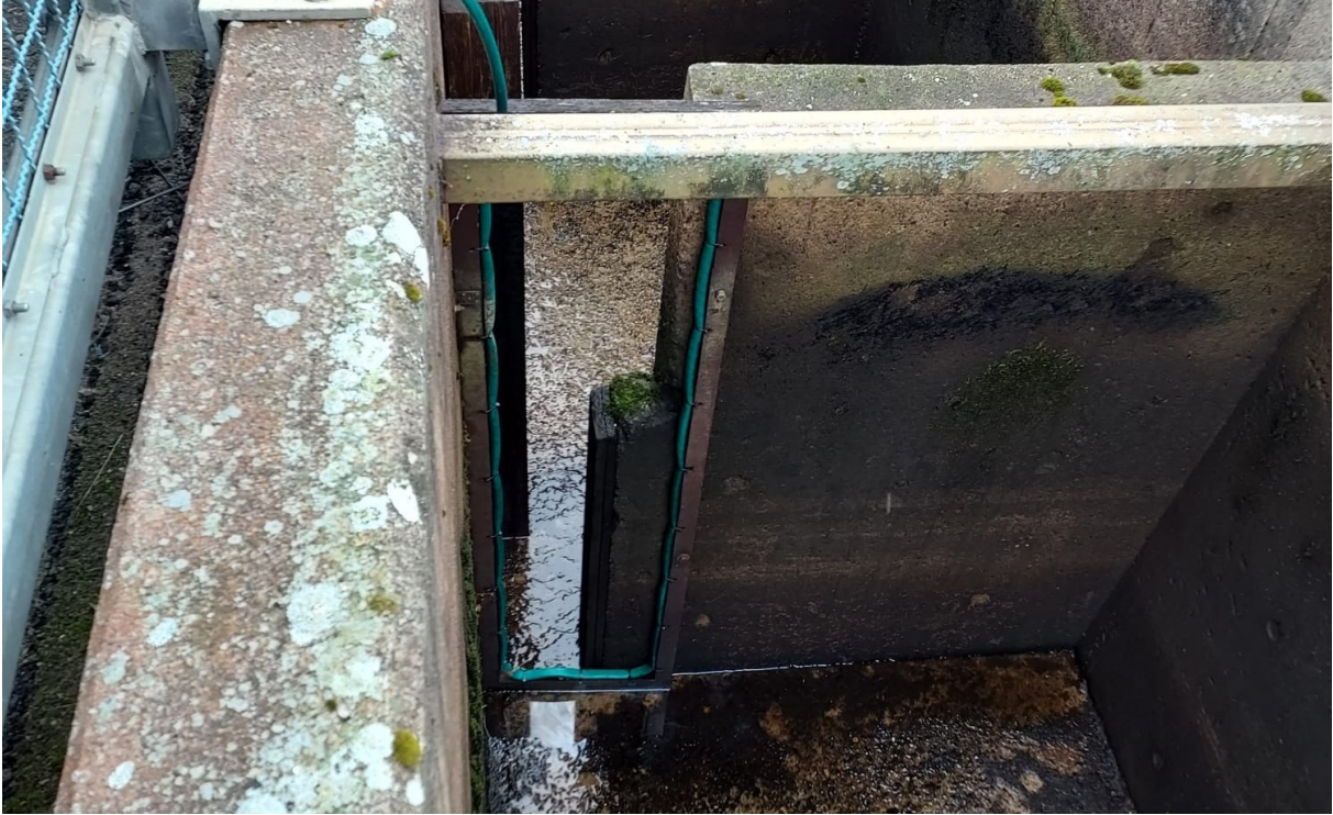
Kuva 8. Vallitunsaaren kalatien alaosan pystyrako-osuudelle asennettu PIT-antenni. Kuva: Mikko Jaukkuri.
