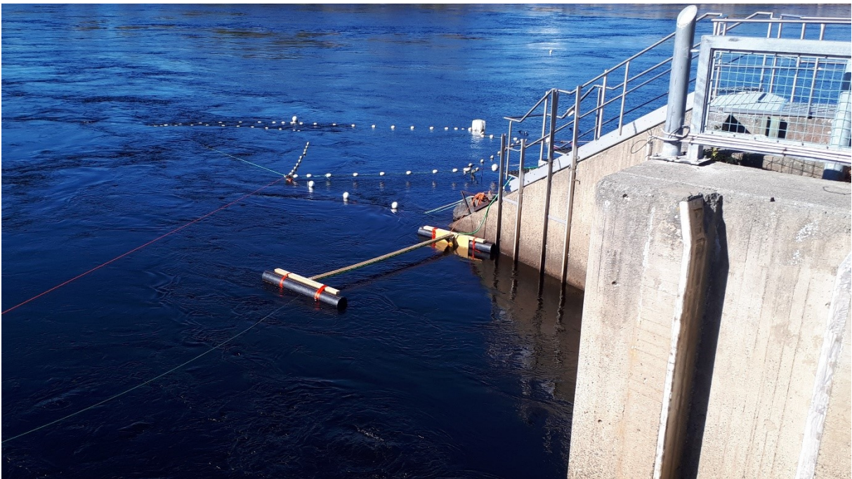
Kuva 9. Vallitunsaaren voimalaitoksen kelluva PIT-antenni. Taustalla näkyy myös yhden tutkimusryhmän sisäänkäynnin rakenteet. Kuva: Mikko Jaukkuri.
