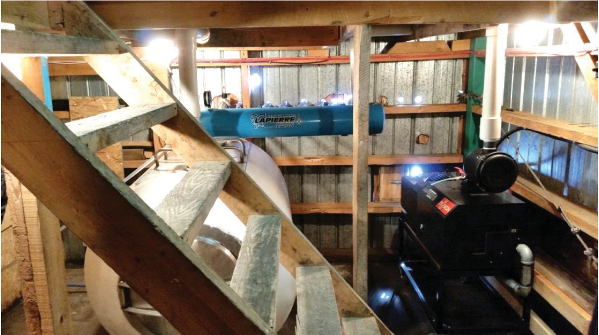
Kuva 21. Vasemmalla on mahlasäiliö ja oikealla alipainepumppu ilmalle (Kuva Jari Miina).
