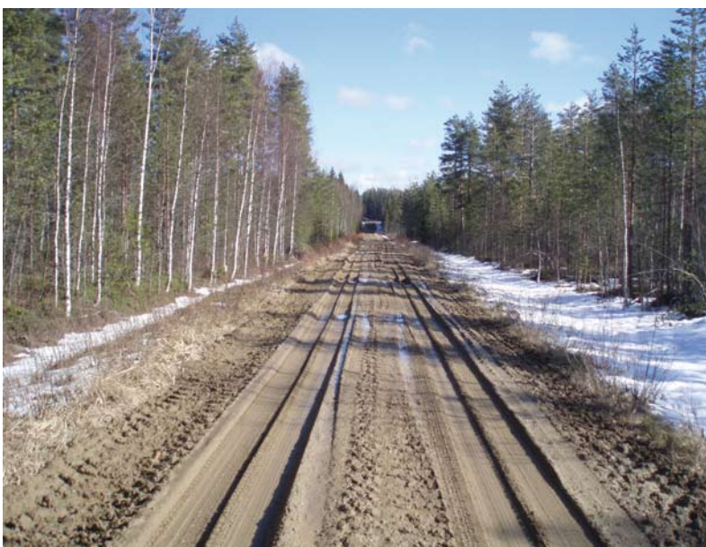
Kuva 3.1. Keväisin metsätiet ovat riskialttiita vaurioitumaan pahoin (Kuva: Tomi Kaakkurivaara 2009).
