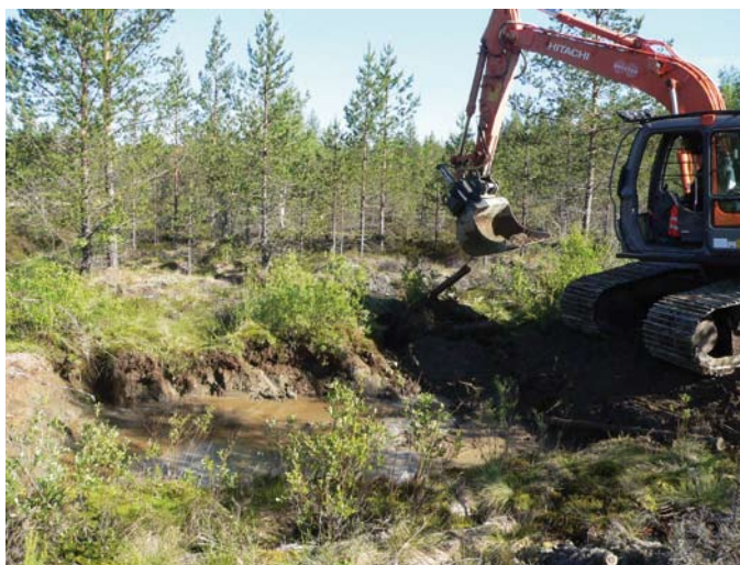
Kuva 2.9. Kaivurilla avataan tietä kerralla puomin mitan verran niin, että kaivussyvyys on selvästi alle pohjavedenpinnan tason (Kuva: Jari Ilomäki 2010).
