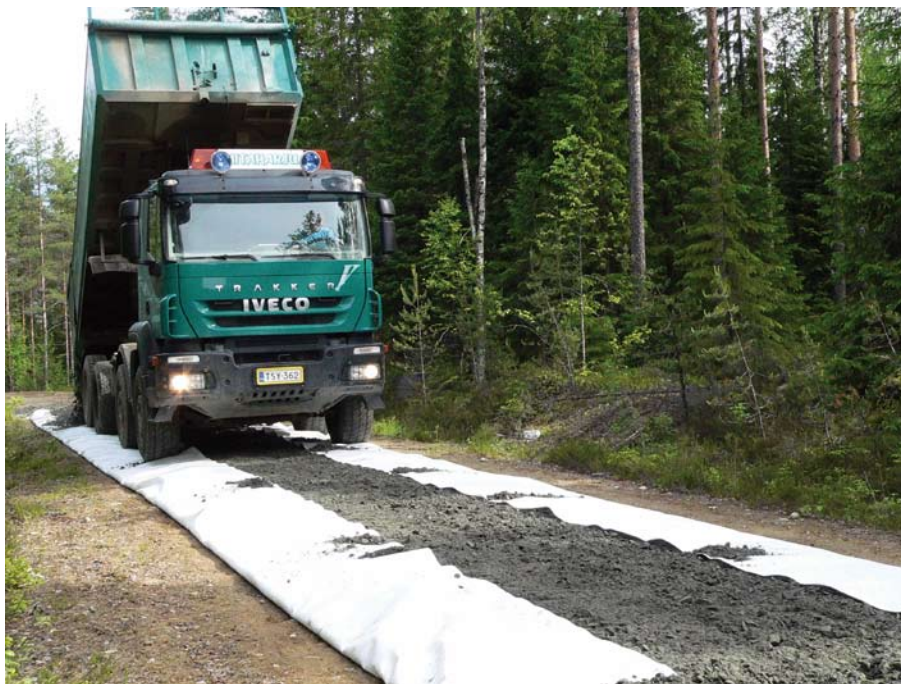
Kuva 2.2. Suodatinkankaan reunat käännettiin tasatun murskekerroksen päälle ja uusi murskekerros levitettiin paketoitua kerroksen päälle (Kuva: Jari Ilomäki 2010).
