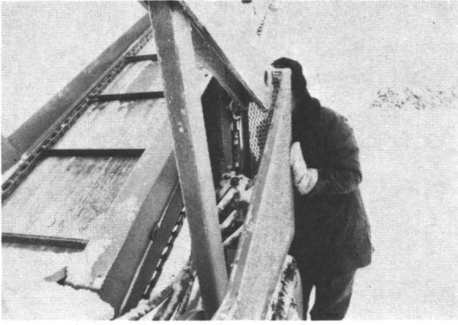
Kuva 17. Syöttöalavan ritilän hydrauliiikan ohjauventtiilien sijoitus.
