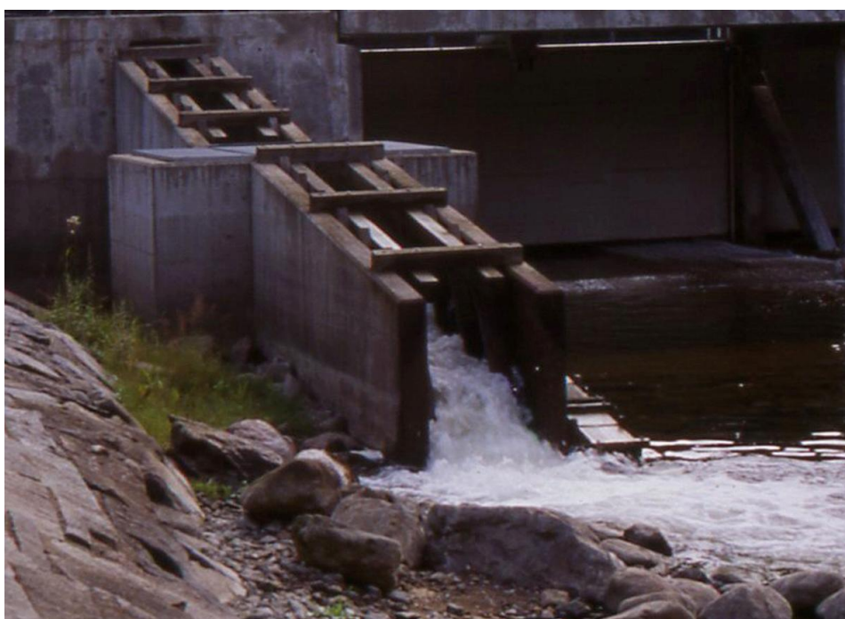
Kuva 9. Denil-tyyppinen kalatien sisäänkäynti Sävarån-joessa Ruotsissa. Tässä kalatie purkaa vettä matalaan jokuomaan ja ratkaisu toimii hyvin. Jos vesisyvyys kalatien sisäänkäynnin alapuolella on suuri, purkautuu vesi kalatien Denil-aukosta vesipatsaan pintaan ja houkutusvirta hajoaa nopeasti, eikä se siksi houkuttele kaloja erityisen tehokkaasti. Kuva: A. Laine, Pohjois-Pohjanmaan ELY-keskus.
