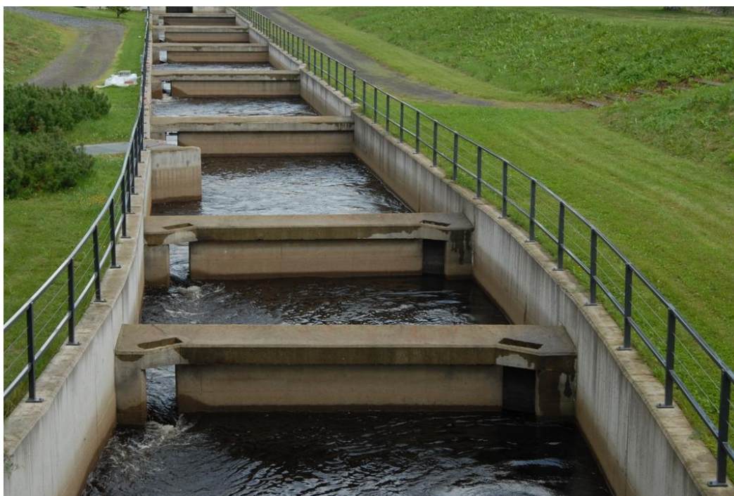
Kuva 1. Rakennetuissa joissa vaelluskalojen kulkuyhteyksiä turvataan yleensä kalateiden avulla. Kuvassa Oulujoen Merikosken kalatien alaosan pystyrako-osuutta. Kuva: P. Orell.
