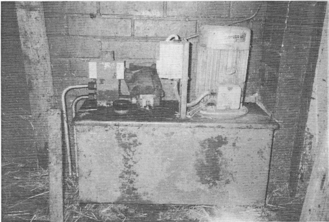
Kuva 24. Lattialle sijoitettu hydraulikoneisto. Pimeässä nurkassa olevan koneen pienet öljyvuodot saattavat jäädä huomaamatta.
