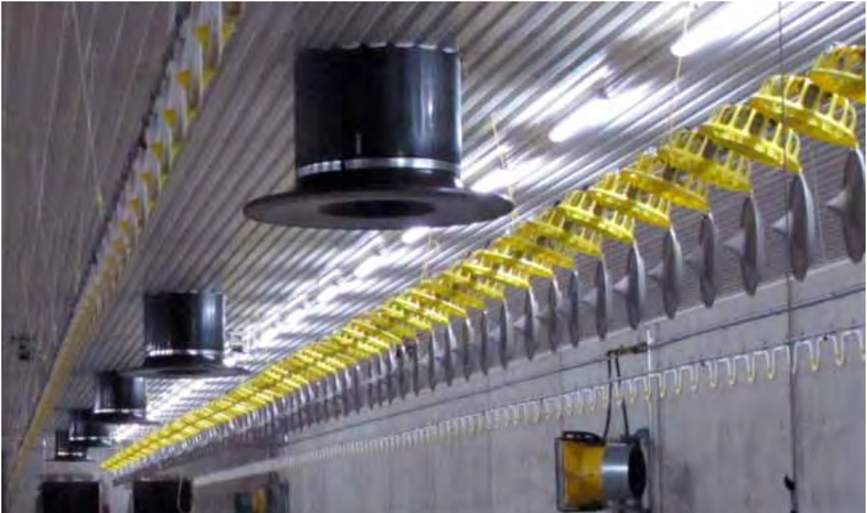
Kuva 22. Säädettävä ulkoilmakanavahajotin, jonka alareuna on noin 80 cm hallin kattopinnasta. Kuvassa ruokintalaitteet on pesun ajaksi nostettu kattoon.
