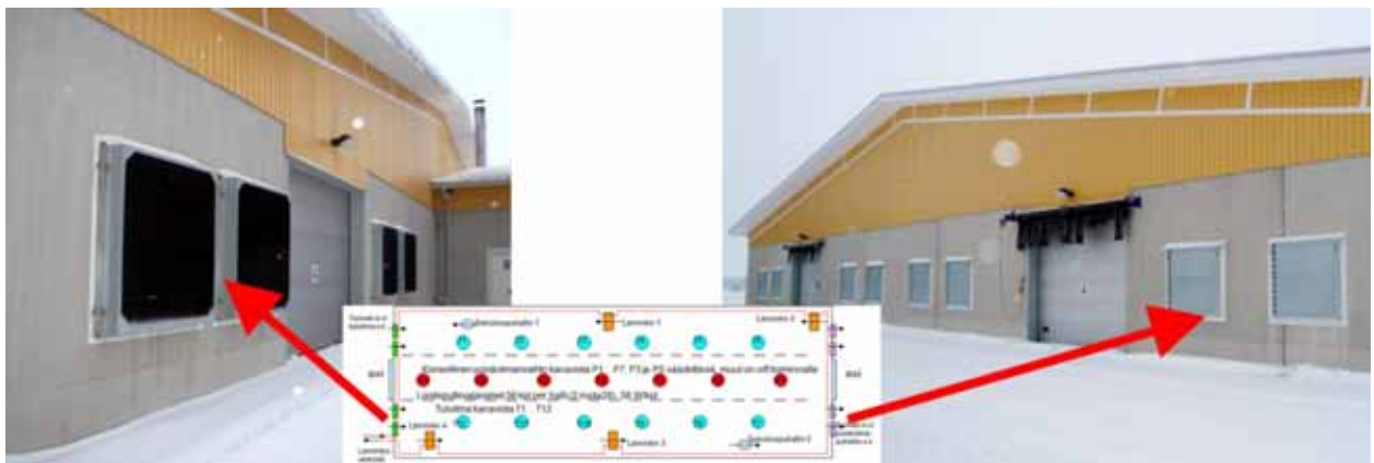
Kuva 24. Hallin päädyn tunneli-ilmanvaihdon tulo- ja poistoilmaluukut.
