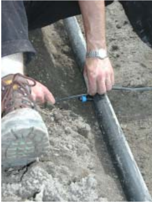
Kuva 4. Tihkuletku liitetään päisteessä olevaan jakolinjaan liittimen avulla. Huolellinen liitostyö vähentää toimintahäiriöitä ja myöhempää paikkaustyön tarvetta. (Kuva Elina Muuttomaa)
