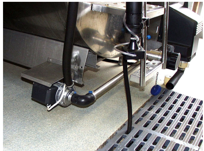
Kuva 3. Oikealla oleva tilasäiliön pesuri ohjaa talteenotettavan pesuveden vasemmalle sijoitetun pumpun avulla katon kautta menevää putkea pitkin varastosäiliöön.
