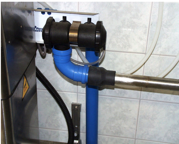
Kuva 2. Pesulaite vasemmalla, musta venttiilistö ohjaa pesurista poistuvan veden joko alas viemäriin tai varastosäiliöön oikealle
