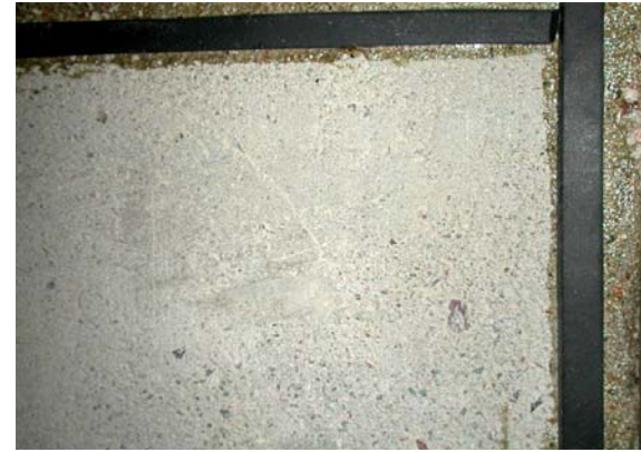
d) hiottu betonipinta
