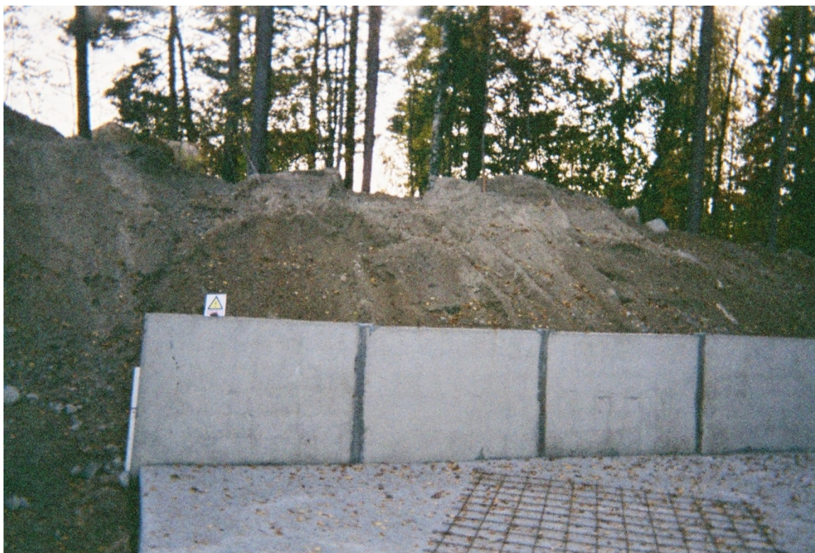
Kuva 3. Liian lähelle jätetyt kaivumassapenkereet aiheuttavat vaaratilanteita työmailla. Myös epätasainen maasto on turvallisuusriski. Kuva: Virve Rinnola.
