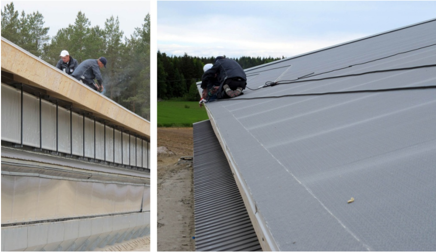
Kuva 6: Tyypillisiä vesikattotöiden riskitilanteita: ei kypärää, ei suojakaiteita eikä turvavaljaita. Kuva: Tapani Kivinen
