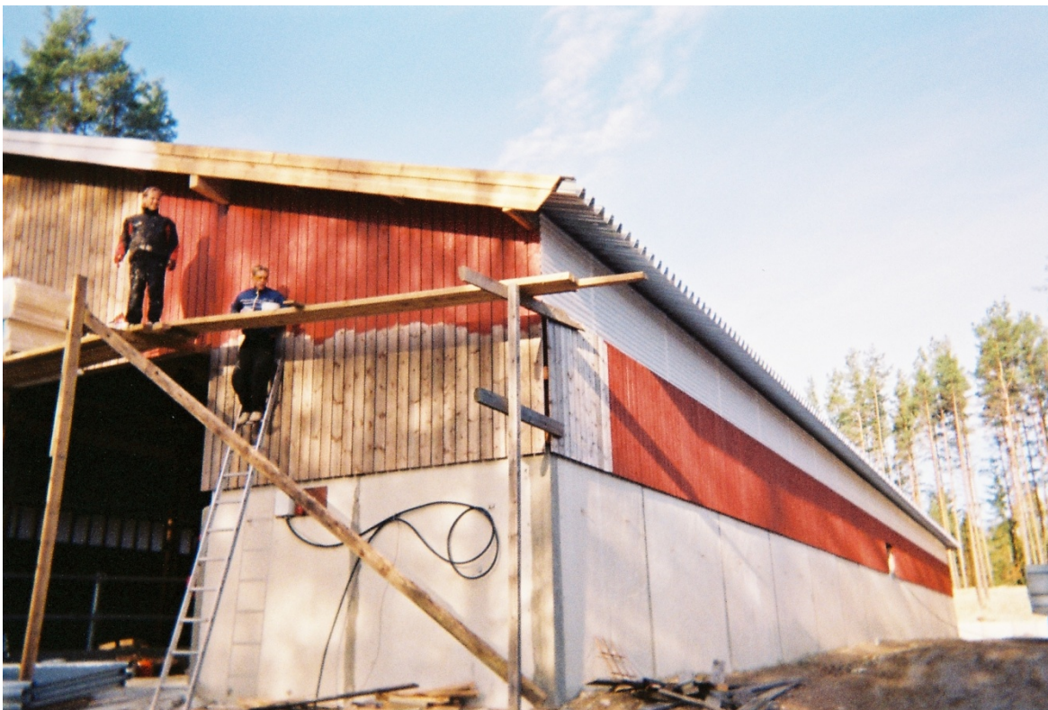
Kuva 2. Tyypilliset itse tehdyt maatalousrakennustyömaan rakennustelineet. Telineet ovat liian kapeat, eikä niissä ole turvakaidetta. Myös tuenta on usein puutteellinen. Kuva: Virve Rinnola.
